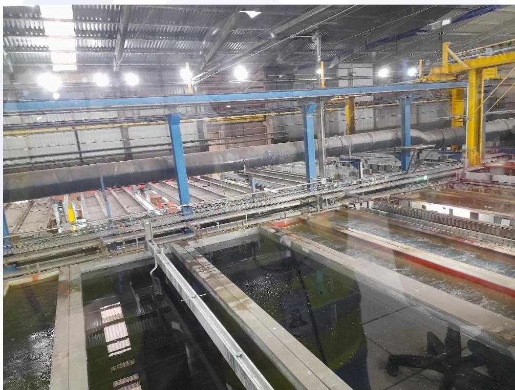
Registro Fotográfico 18: Tanques de anodização.
