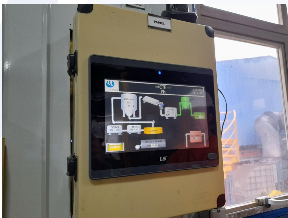
Registro Fotográfico 21: Sistema de Monitoramento da ETE.
