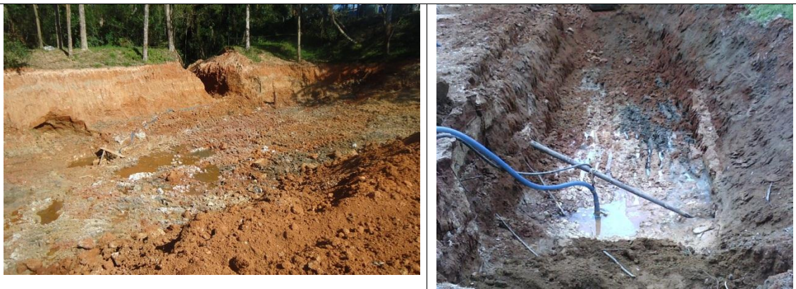
Figura 11 – Local próximo ao dique, mostrando o ponto mais a jusante utilizado para captar e bombear a água aflorante, após verificação de sua qualidade.
