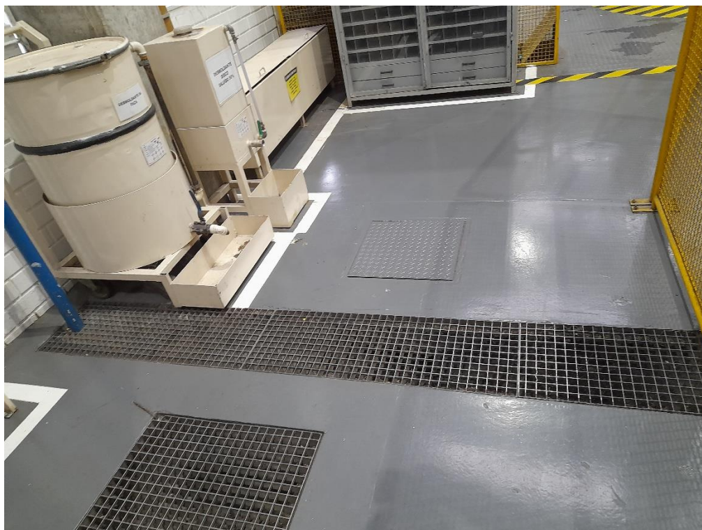
Registro Fotográfico 17: Vista geral de equipamento de contenção em casos de derramamento.
