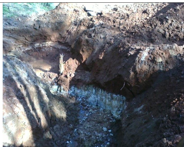
Figura 16 – Exposição da camada de resíduos (cinza clara), abaixo da capa de cobertura de argila.
