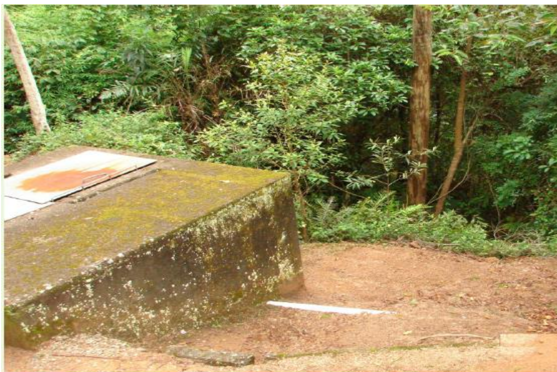
Figura 5 - Ponto de captação: caixa e hidrômetro
