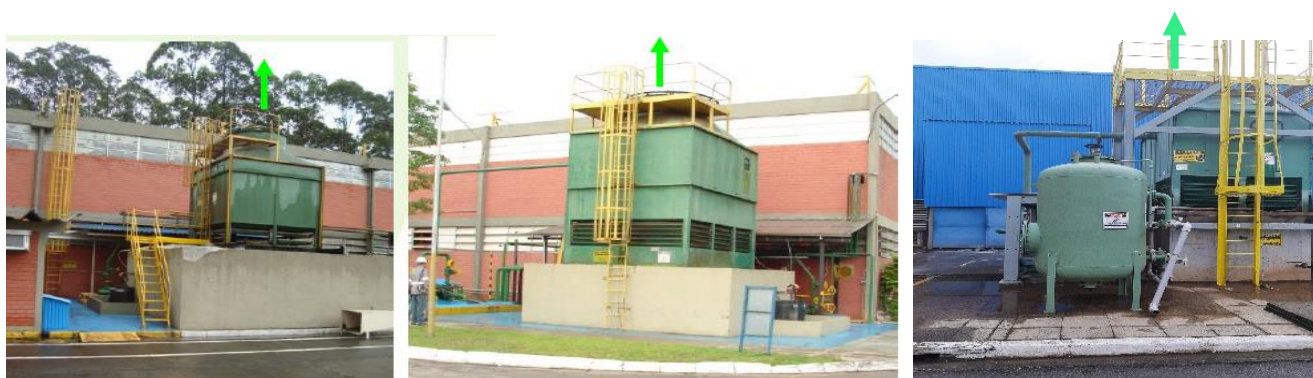
Figura 27 Exaustão das torres de resfriamento as prensas
