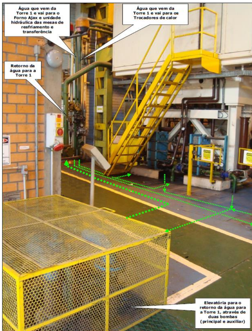
Figura 20 - Circuito de tubulações de água de resfriamento na cabeceira da prensa I e trocador de calor
