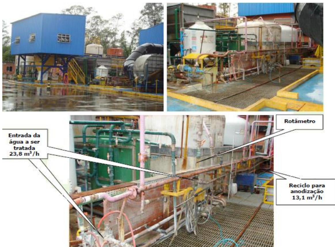
Figura 30 - Detalhes de tubulações na ETE
