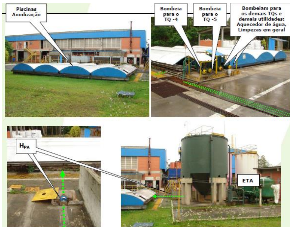
Figura 18 - Foto mostrando detalhes como posições, tubulações e operacional na piscina de água da anodização
