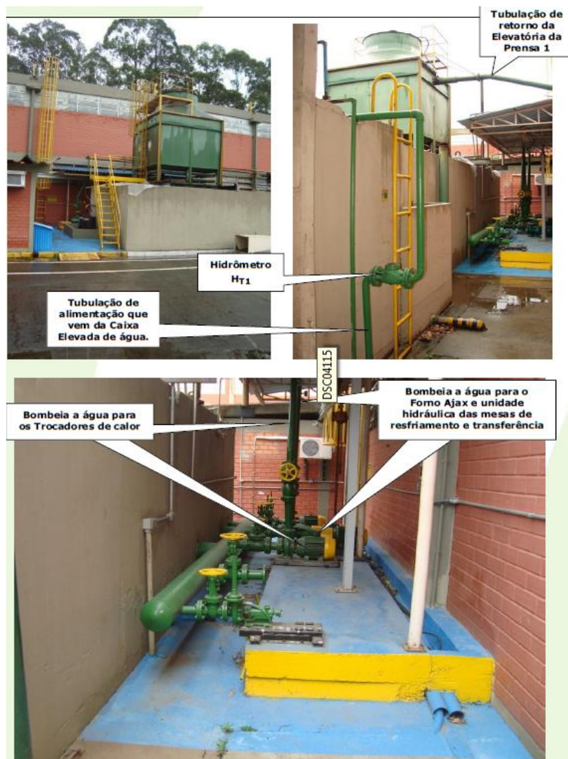
Figura 21 - Circuito de tubulações de água de resfriamento e bombas na torre 1
